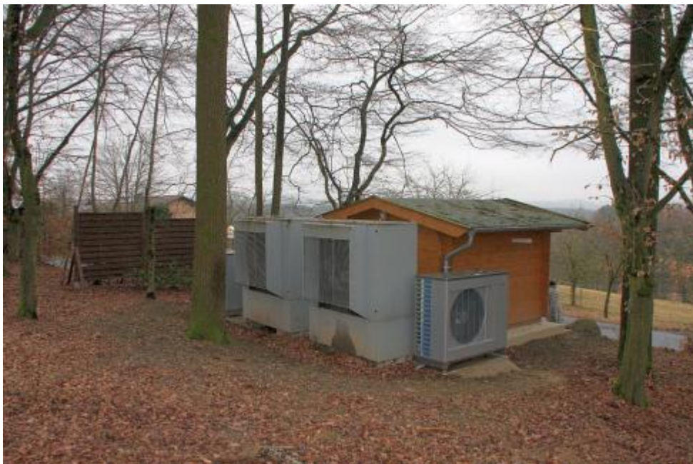
Abbildung 6-2: Wärmetauscher der Luft-/Wasser-Wärmepumpe des Nahwärmenetzes Büschhof 98
