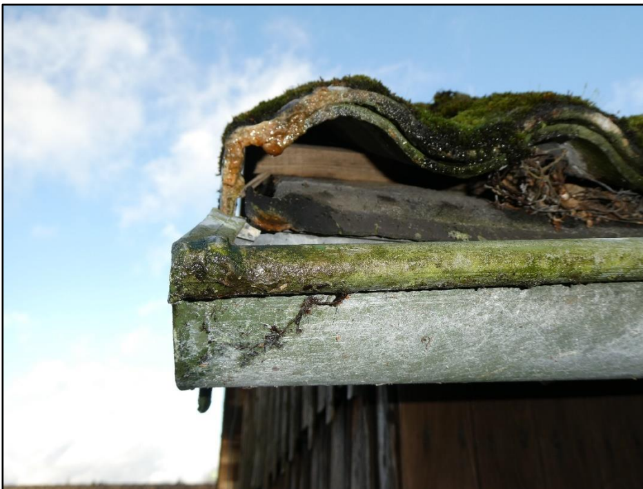
Abb. 9: Öffnung im Dach eines Holzschuppens
